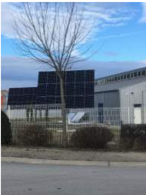
Panneaux photovoltaïques dans la zone d'activités d'Aouste-sur-Sye
